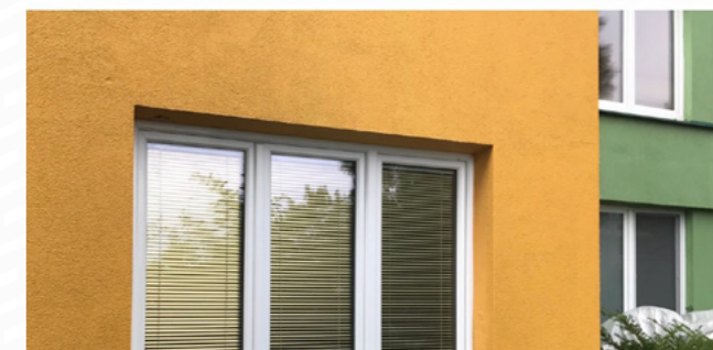
viditelný rozdíl mezi čistou a špinavou fasádou
